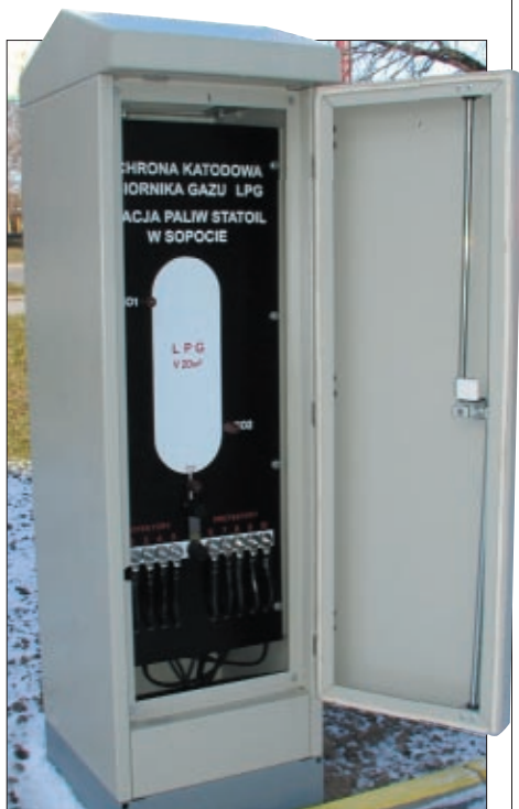
Wewnątrz znajdują się wyprowadzenia elektryczne od elementów instalacji ochrony katodowej. Umożliwiają one określenie skuteczności zabezpieczenia przeciwkorozyjnego zbiornika.
