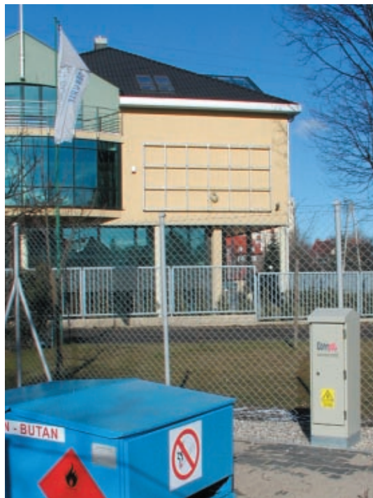
Ta pionowa metalowa skrzynka stojąca poza strefą zagrożenia Z2, to jedyna na powierzchni ziemi oznaka zastosowanej ochronie katodowej zbiornika.
